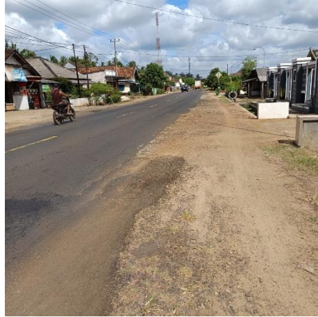
Gambar 3. Peralihan aspal bahu jalan tidak rata.
