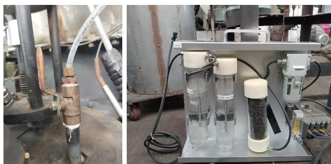
Gambar 10. Katup gas dan gas analyzer conditioning .
