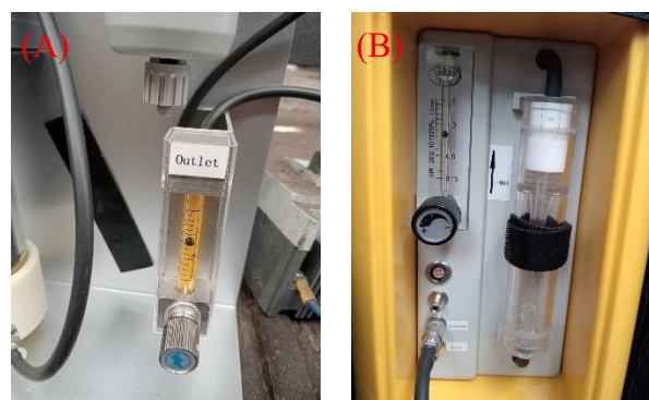
Gambar 10. Outlet pada gas analyzer conditioning (A); gas inlet port pada Portable Infrared Syngas Analyzer Gasboard G3100-P .
