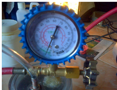
Gambar 3.26. Pressure gauge berada pada 20 psi tekanan vakum.
