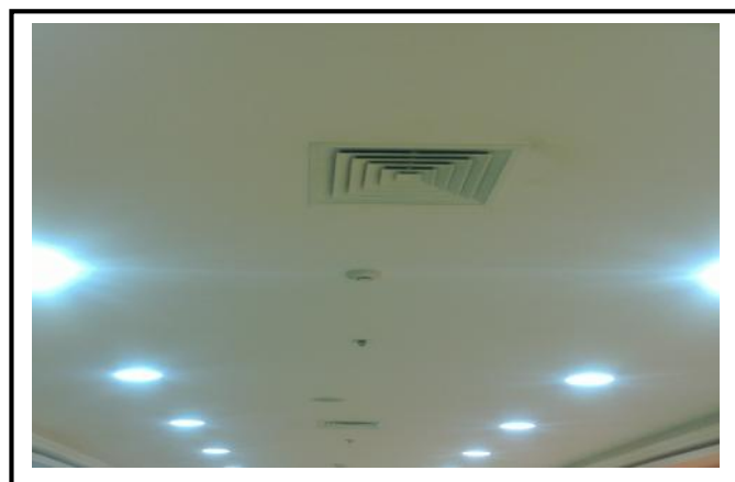
Gambar 8. Pemasangan detektor asap dan panas dengan sistem panel di kombinasikan dengan sprinkler
