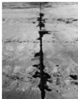
Gambar 17. Tingkat kerusakan pemompaan ( pumping )
