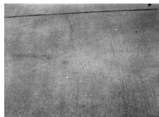
Gambar 19. Tingkat kerusakan Retak susut ( shrinkage cracks )
