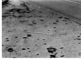
Gambar 14. Tingkat kerusakan pelepasan ( popouts )
