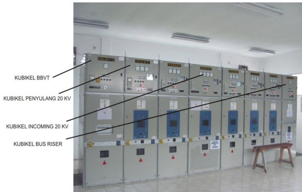
Gambar 2.13 Kubikel 20 kV (foto pada GI New Tarahan atas seizin PT. PLN Persero)
