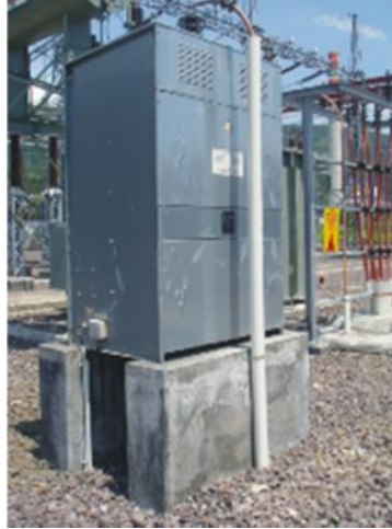
Gambar 2.4 NGR (Netral Ground Resistor) (foto NGR pada GI New Tarahan atas seizin PT.PLN persero)
