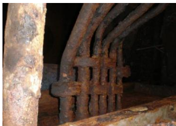
Gambar 2. Korosi seragam pada pipa ballast (Utomo, 2009).
