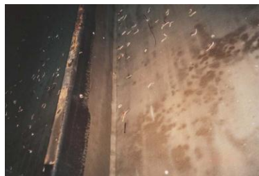
Gambar 9. Korosi mikrobiologi (Utomo, 2009).
