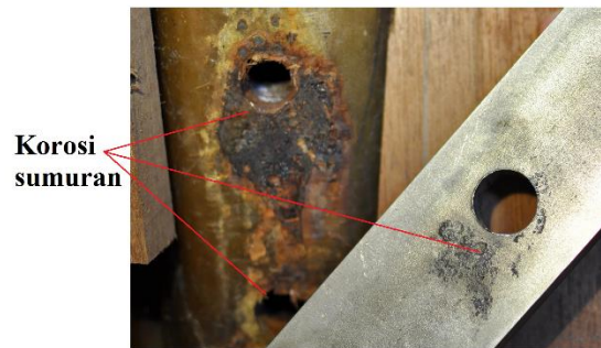
Gambar 2.2. Korosi sumuran (Cramer dan Bernard, 2003)
