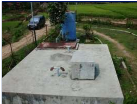
Gambar 11. Reservoir IPA Banyumas Kapasitas 40 m 3 .
