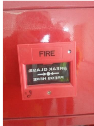
Gambar 3.41. Manual Push Button (Sumber : Dokumentasi Lapangan,2021)
