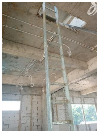
Gambar 3.27. Cable Ladder (Sumber : Dokumentasi Lapangan,2021)
