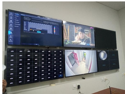
Gambar 3.48. Layar Monitor (Sumber : Dokumentasi Lapangan,2021)
