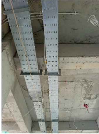
Gambar 3.28. Tray Cable (Sumber : Dokumentasi Lapangan,2021)
