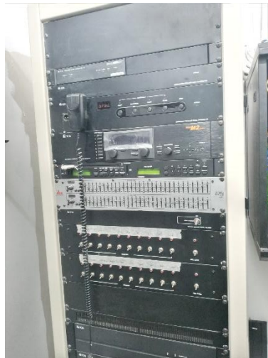
Gambar 3.52. Main Unit Sound System (Sumber : Dokumentasi Lapangan,2021)
