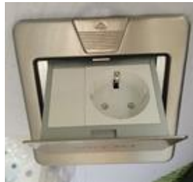
Gambar 3.38. Floor Outlet (Sumber : Dokumentasi Lapangan,2021)
