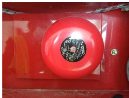
Gambar 3.42. Alarm Bell (Sumber : Dokumentasi Lapangan,2021)
