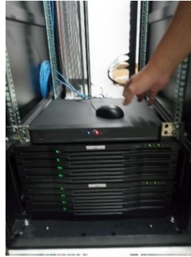
Gambar 3.47. NVR (Sumber : Dokumentasi Lapangan,2021)
