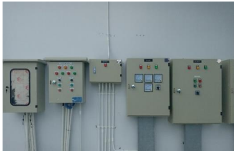
Gambar 3.30. Box Panel (Sumber : Dokumentasi Lapangan,2021)
