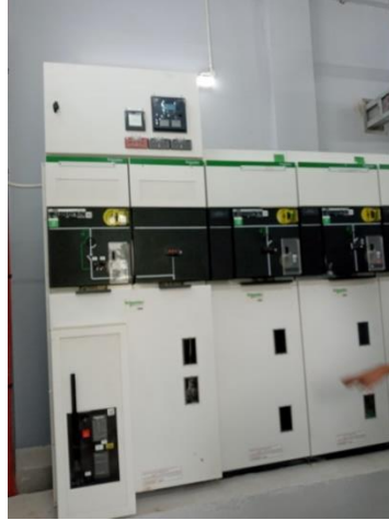
Gambar 3.22. MVMDP (Sumber : Dokumentasi Lapangan,2021)
