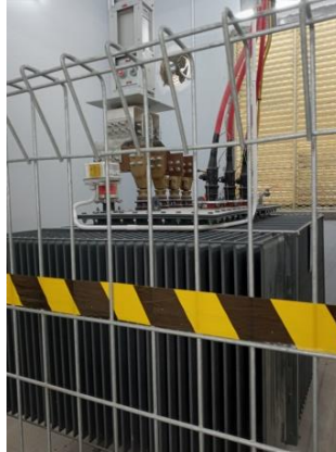
Gambar 3.26. Trafo/ Transformator Step Down (Sumber : Dokumentasi Lapangan,2021)
