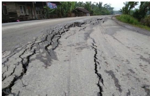
Gambar 2.1. Kerusakan Perkerasan Jalan Akibat Kembang-Susut Tanah.
