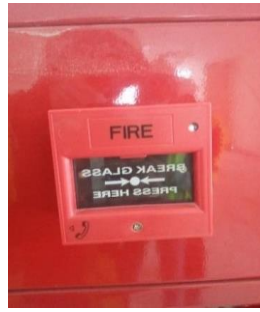
Gambar 3.43. Manual Push Button (Sumber : Dokumentasi Lapangan,2021)
