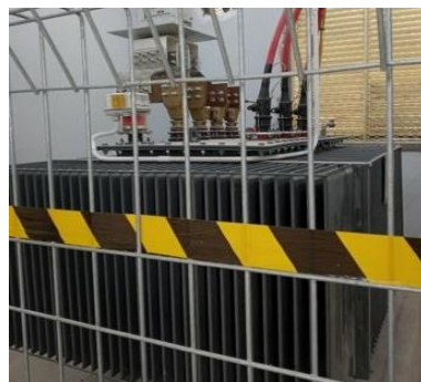
Gambar 3.24. Trafo/Transformator Step Down (Sumber : Dokumentasi Lapangan,2021)
