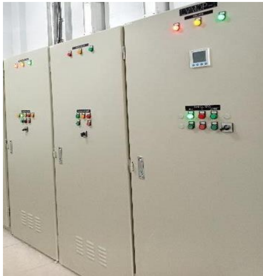
Gambar 3.20. LVMDP (Sumber : Dokumentasi Lapangan,2021)
