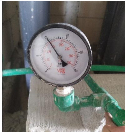
Gambar 3. 17 Alat pengukur tekanan udara ( Pressure Gauge ) Sumber: Dokumentasi Lapangan
