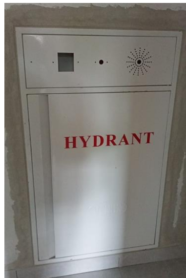
Gambar 3. 38 Hydrant box Sumber: Dokumentasi lapangan
