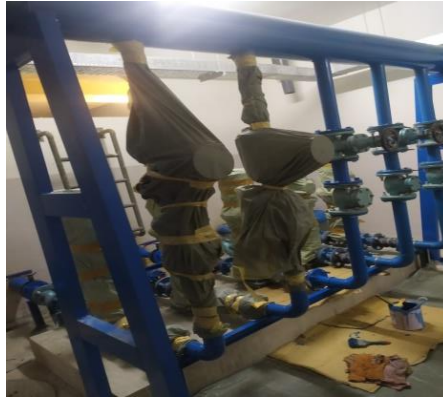
Gambar 3. 18 pompa booster Sumber: Dokumentasi Lapangan
