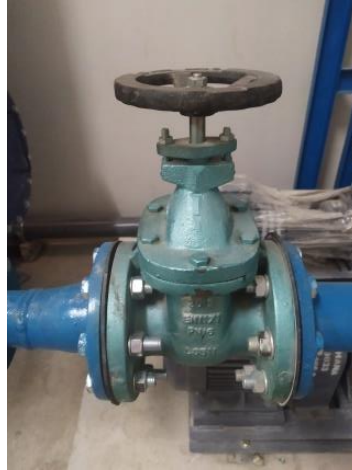
Gambar 3. 21 Gate valve Sumber: Dokumentasi lapangan
