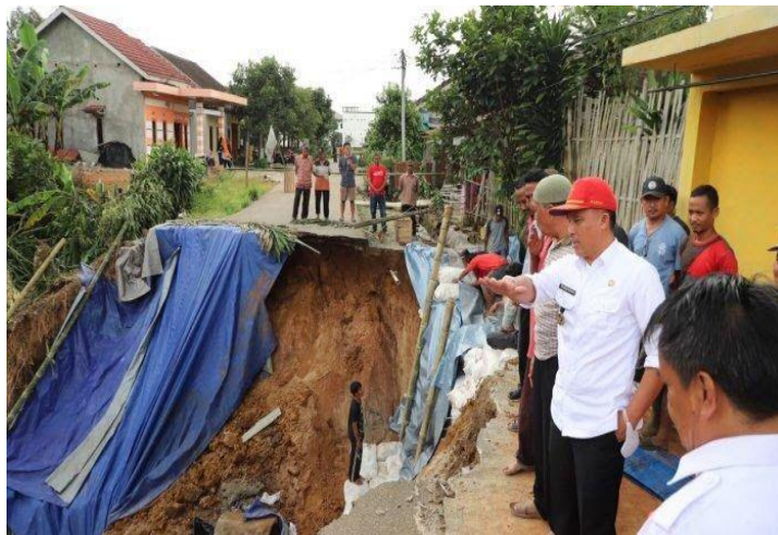
Gambar 5. Longsor di Kecamatan Way Tenong
