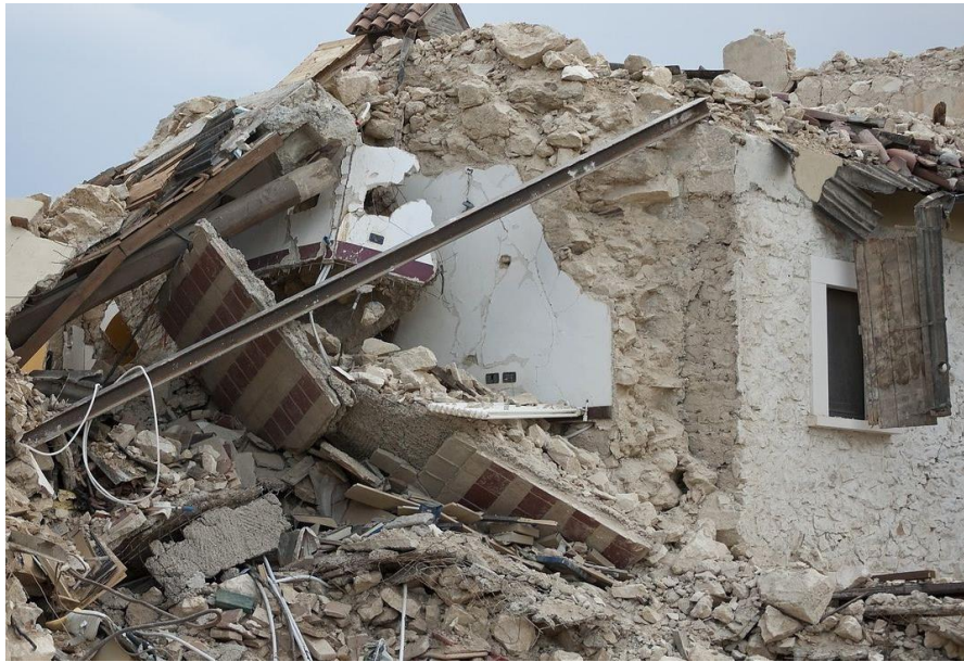
Gambar 1. Kerusakan gempa Banten tahun 2022 (Sumber: HarianHaluan.com).
