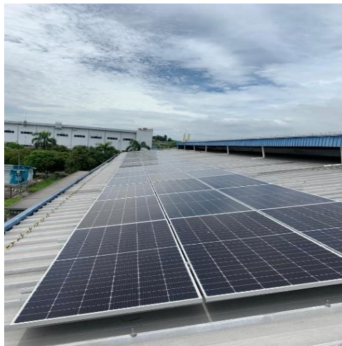
Gambar 2. 1 Pembangkit Listrik Tenaga Surya
