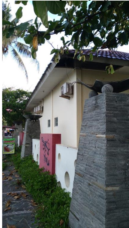
Gambar 1.2 Fasilitas Pendopokan yang Rusak
