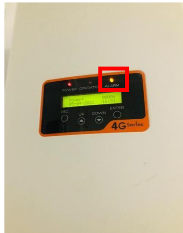
Gambar 3.13 LED Indicator Alarm tidak menyala
