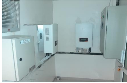
Gambar 3.20 PV Inverter dalam keadaan baik dan bersih
