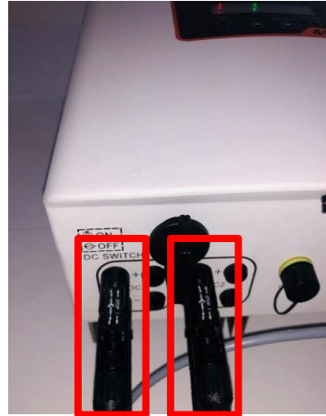
Gambar 3.8 Koneksi String pada Inverter
