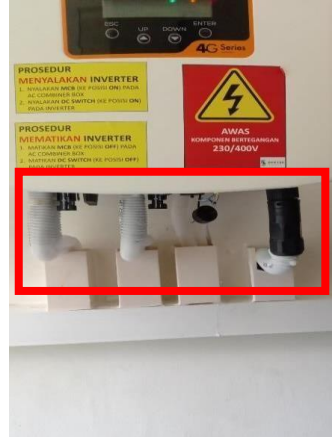
Gambar 3.2 menunjukkan koneksi kabel pada inverter
