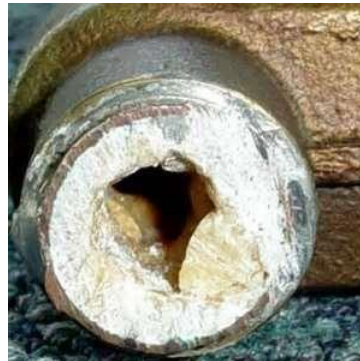
Gambar 1. Kerak magnesium karbonat pada pipa (Mandela, 2017).
