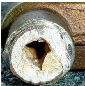
Gambar 10. Endapan kerak magnesium karbonat dalam pipa (Mandela, 2017).
