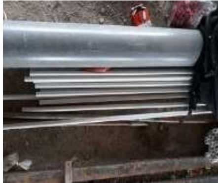
Gambar 3.28. Pipa Conduit (Sumber : Dokumentasi Penulis,2022)
