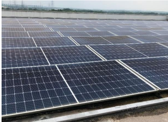
Gambar 3. Pembangkit Listrik Tenaga Surya
