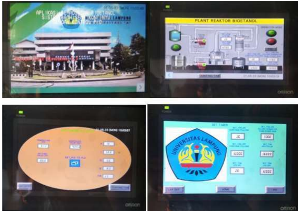
Gambar 3. 19. Tampilan HMI dilihat searah jarum jam, tampilan halaman depan penelitian, lay out diagram proses, tampilan seting waktu, seting PID kontrol, dan set point suhu reaktor.
