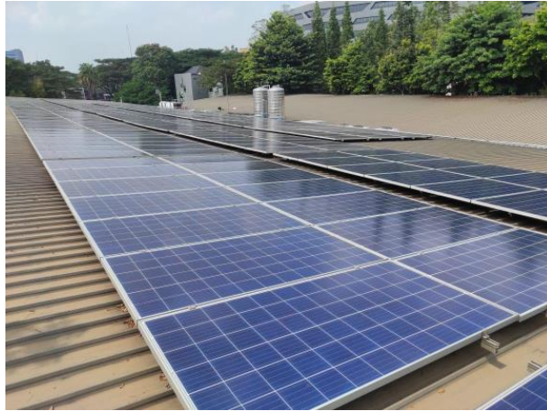
Gambar 1. Pembangkit Listrik Tenaga Surya (PLTS)
