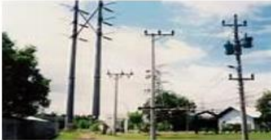
Gambar 2. Saluran Udara Tegangan Menengah
