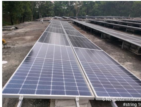
Gambar 1 Pembangkit Listrik Tenaga Surya
