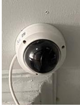
Gambar 3.15 Kamera CCTV (Sumber : Dokumentasi Pribadi)
