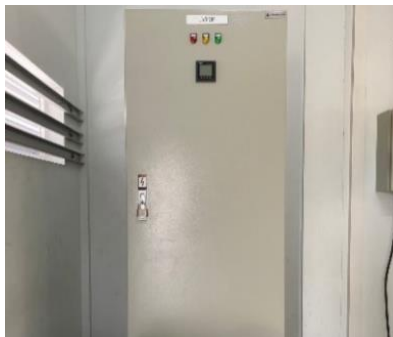
Gambar 3.3 LVMDP (Sumber : Dokumentasi Pribadi)
