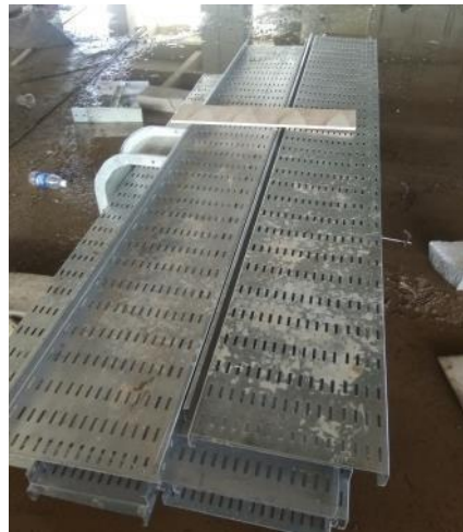
Gambar 3.7 Cable Tray (Sumber: DokumentasiPenulis,2022)
