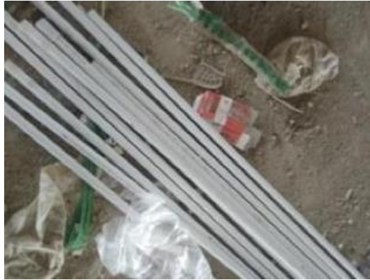
Gambar 3.8 Pipa Conduit (Sumber: Dokumentasi Penulis, 2022)
