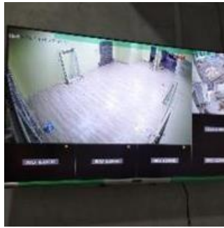
Gambar 3.15 Tv Monitor (Sumber: Dokumentasi Penulis, 2022)
