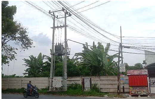
Gambar 4. 20 Gardu Listrik Disekitar Site Sumber : Dokumentasi Penulis
