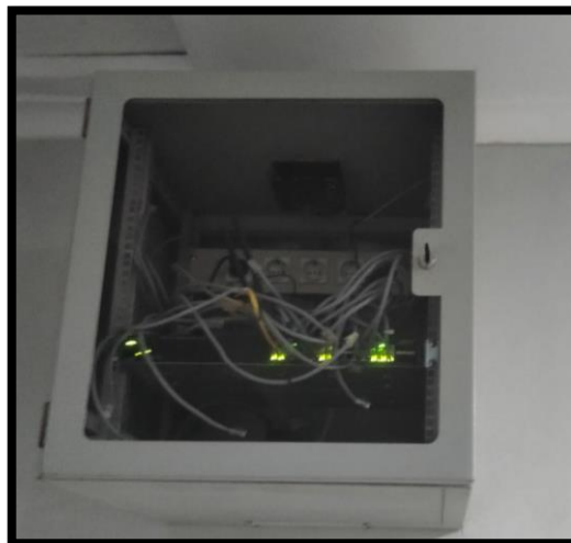
Gambar 3.14 NVR (Sumber :Dokumentasi Lapangan)
