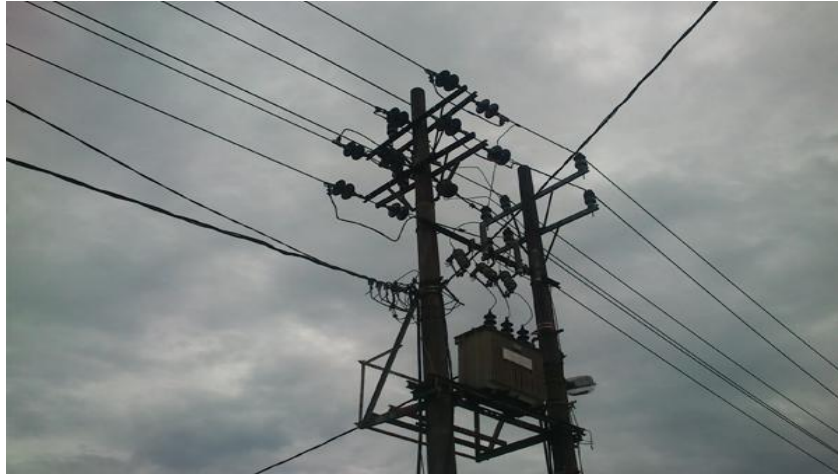
Gambar 2. 1 Saluran Udara Tegangan Menengah (SUTM)
