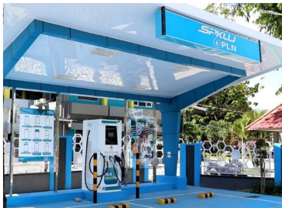
Gambar 2.4 Stasiun Pengisian kendaraan listrik umum
