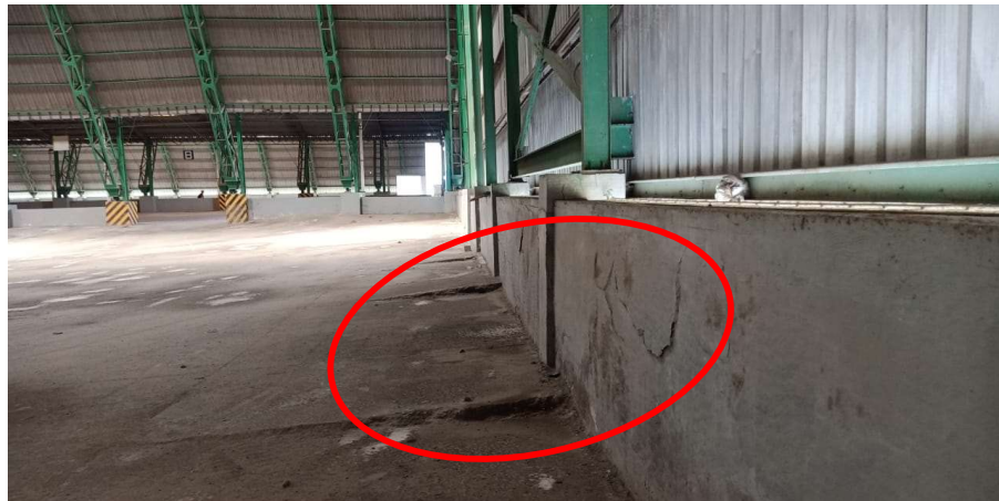
Gambar 3. Kondisi Kerusakan Struktur Gudang (Sumber: Survei Penelitian, 2023)
