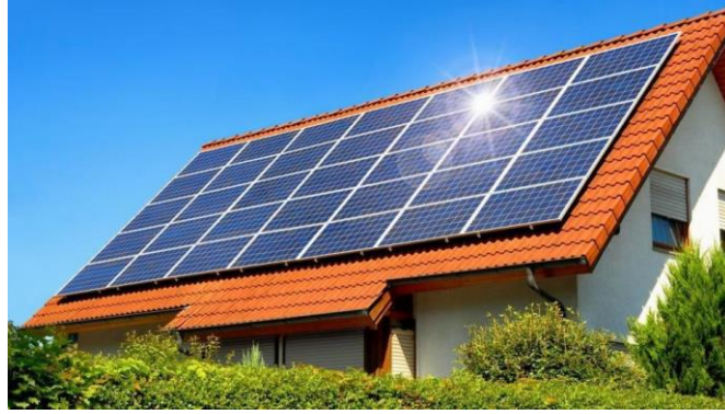
Gambar 1. Pembangkit Listrik Tenaga Surya (PLTS)
