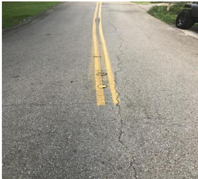
Gambar 3. Longitudinal Crack (Wang et al. , 2023).
