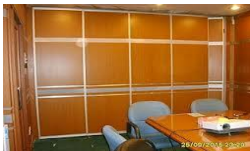
Gambar 2.9. Dinding redam suara pada ruang meeting perkantoran.
