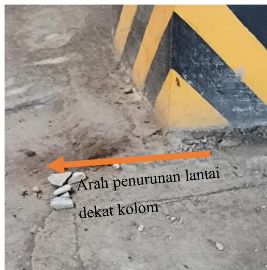
Gambar 2. Kondisi Penurunan Lantai Samping Kolom. (Sumber: Survey Penelitian , 2023)
