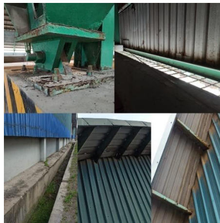
Gambar 4. Kerusakan pada Rangka Atap Baja.
