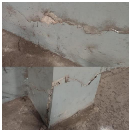
Gambar 5. Kerusakan pada Kolom dan Tie Beam .
