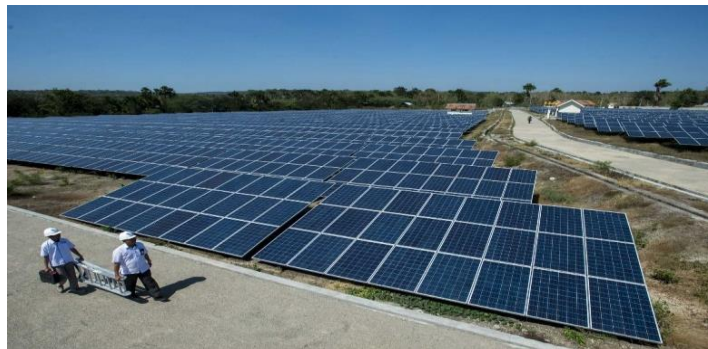
Gambar 2. 1 Pembangkit Listrik tenaga surya
