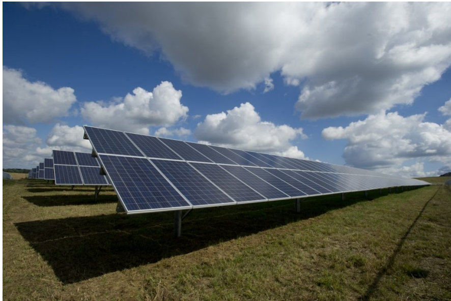
Gambar 1 Pembangkit Listrik Tenaga Surya
