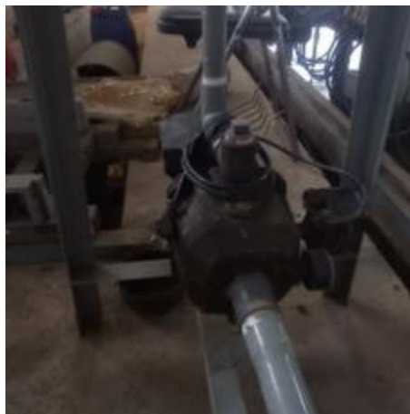
Gambar 12. Mesin pompa air.
