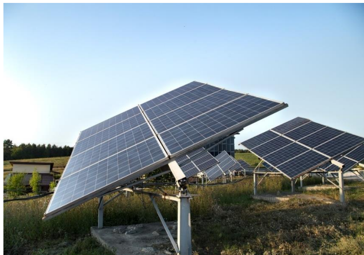
Gambar 1 Pembangkit Listrik Tenaga Surya
