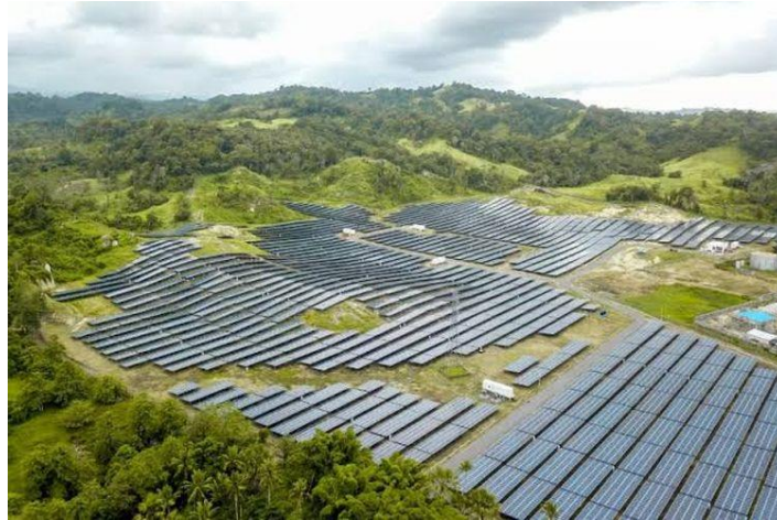
Gambar 2.11 Pembangkit Listrik Tenaga Surya (PLTS) (Sumber: https://images.app.goo.gl/YcCTozb43rxfYziD8 )
