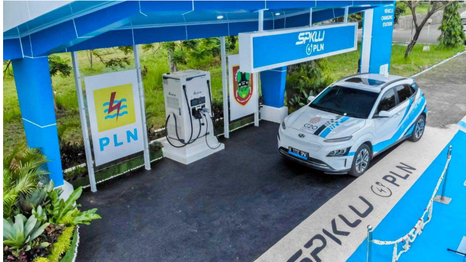
Gambar 2.3 Stasiun Pengisian Kendaraan Listrik Umum (SPKLU) (Sumber: https://images.app.goo.gl/JK2ALdrSDuzv8KtSA )
