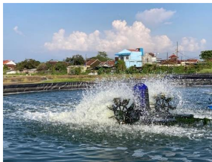
Gambar 3. Kincir air yang digunakan pada MSF
