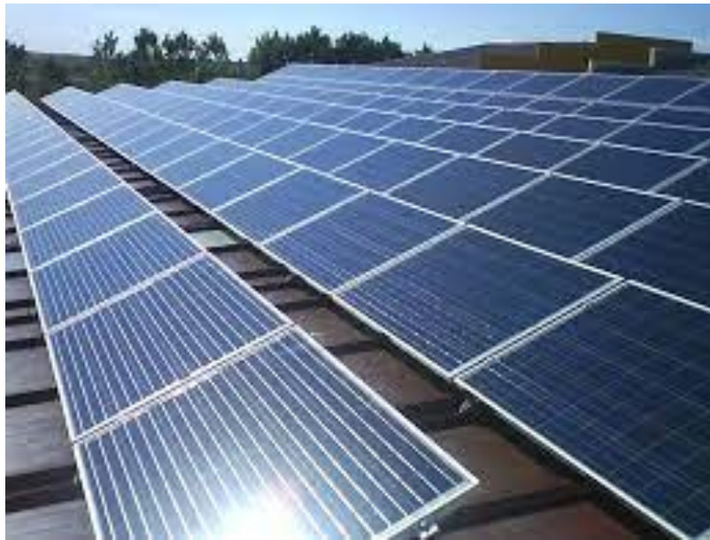
Gambar 2. 8 Pembangkit Listrik Tenaga Surya
