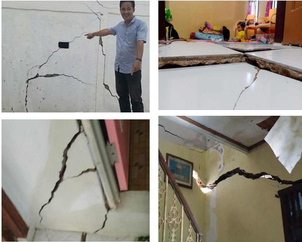
Gambar 2 Kondisi Rumah Retak di Perumahan Rafika 4 (sumber https://sumsel.tribunnews.com/2020/ )
