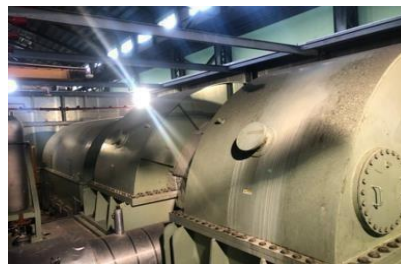
Gambar 2.3 Turbin dan Generator
