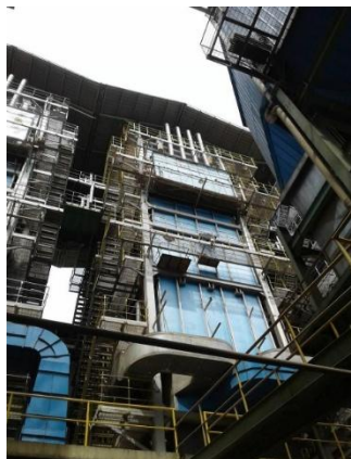
Gambar 3.1 Boiler yang digunakan di PT. XYZ.
