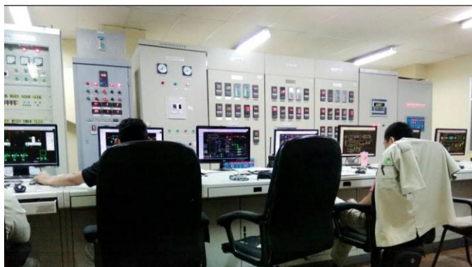
Gambar 3.2 Unit komputer pada CCR dan equipment DCS di PLTU PT. XYZ.
