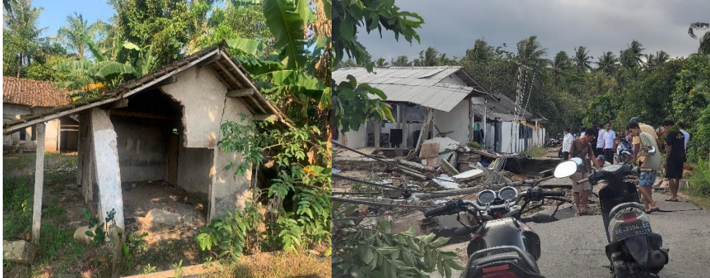
Gambar 14 Kerusakan rumah warga yang diakibatkan bencana banjir di Kecamatan
