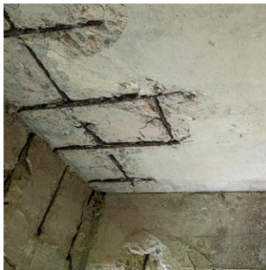
Gambar 2. Scaling pada beton.
